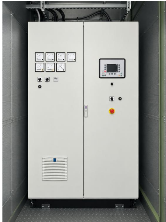
Steuerung und Messung in einer abgestimmten Schaltanlage
