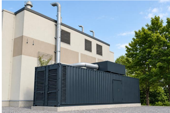
Gebäudenaher Containeraufstellung mit abgestimmter Luft- und Abgasführung
