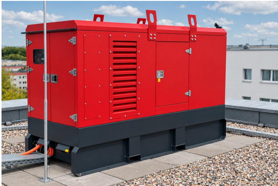
Schallgedämmte Netzersatzanlage in Außenaufstellung
