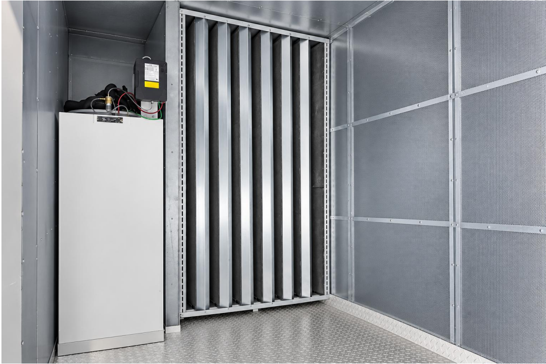
Technischer Innenausbau mit Luftführung und integrierten Nebenanlagen
