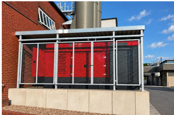
Eingehauste Außenaufstellung mit Schutz- und Wartungszugang
